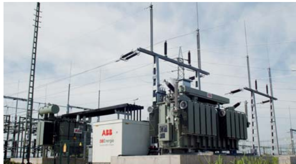
Transformator eines Unterwerkes
