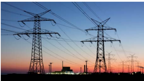
Stromleitung des öffentlichen Landesnetzes
